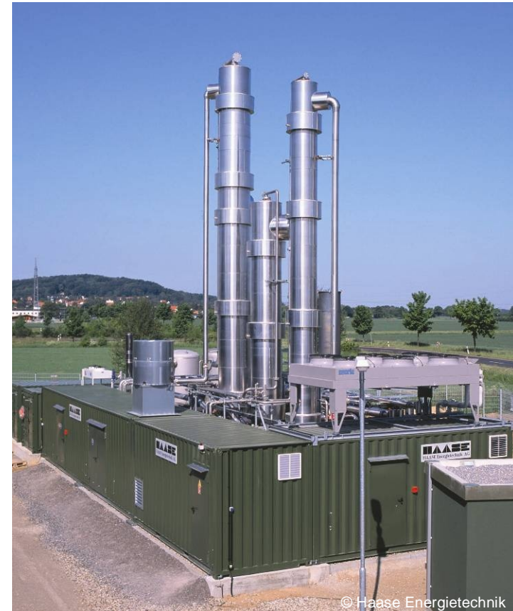
Genosorb-Wäsche, Haase-Energietechnik, Ronnenberg
